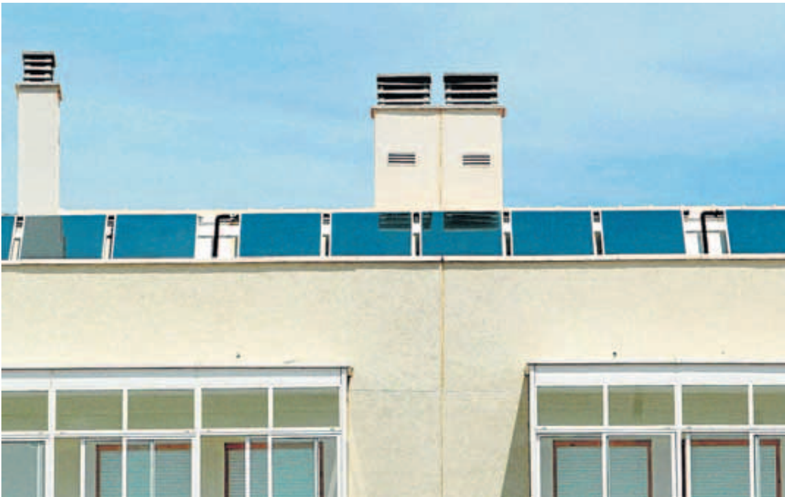
Placas solares en la cubierta de unas viviendas de Parque Goya en Zaragoza. HERALDO
