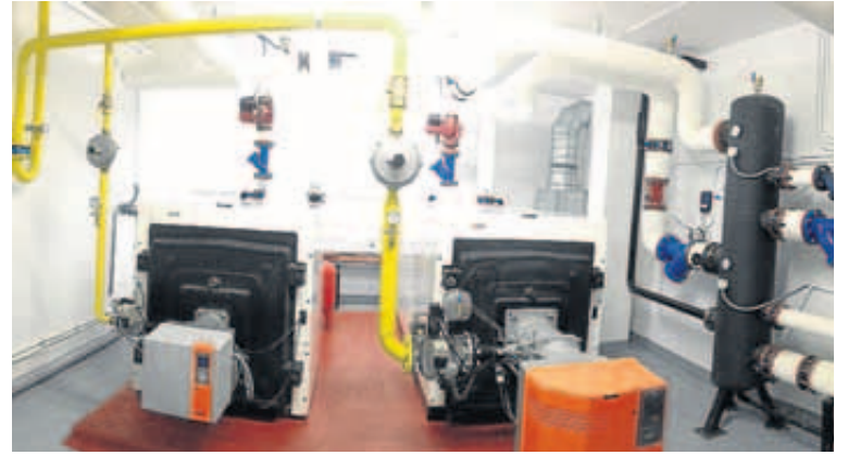
Reciente transformación a gas natural en calefacción y agua caliente.
